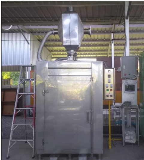
รูปที่ 3 การติดตั้งเครื่องแลกเปลี่ยนความร้อนแบบไหลขวางกับเครื่องอบแห้งแบบลมร้อนระดับกึ่งอุตสาหกรรม
