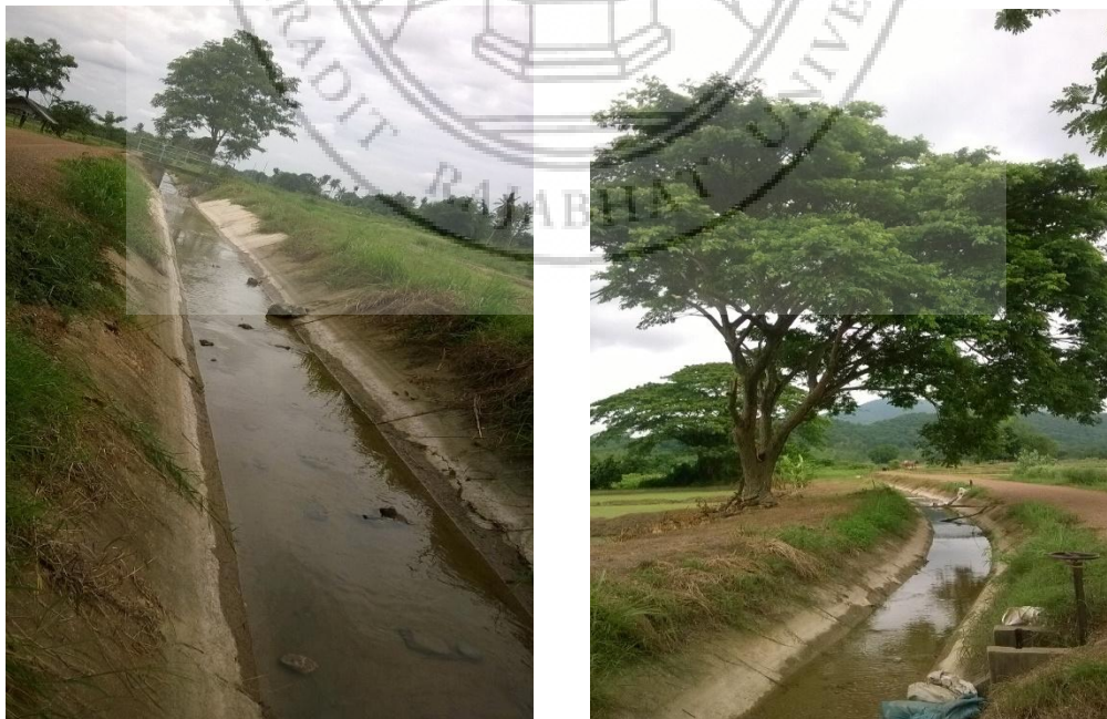
ภาพที่ 4.46 คลองส่งน้ำจากฝายชำบอนฝั่งตะวันตกเพื่อจัดสรรน้ำสู่พื้นที่เกษตรกรรมของชาวบ้าน
