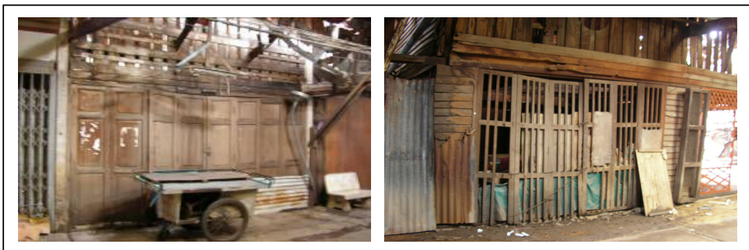
ภาพที่ 4.45 อาคารที่ทรุดโทรม ไม่สามารถใช้ประโยชน์ได้ เต็มไปด้วยหยากไย่ ที่มา ถ่ายจากสถานที่จริง , 2552
