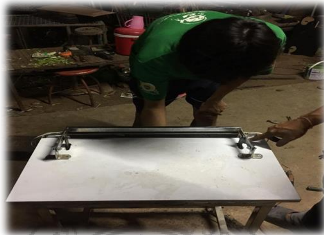
ภาพ 3.6 แสดงภาพการนำชุดปิดผนึกถุงพลาสติกมาทำการยึดติดกับโครงสร้างให้แน่นหนา
