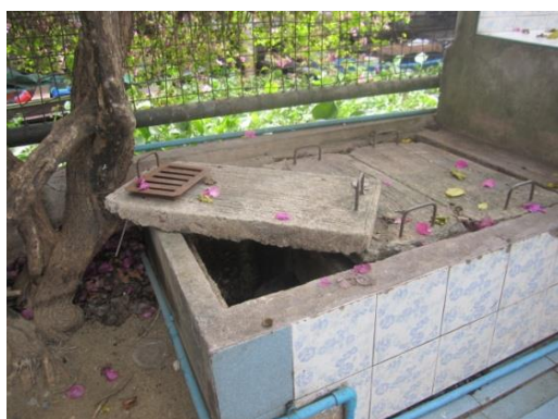
ภาพที่ 4.2 บ่อดักไขมันสภาพก่อนเปิด
