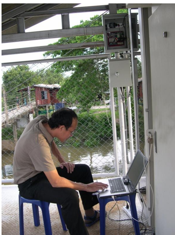
รูปที่ 3.12 การโหลดโปรแกรมเข้าตัวประมวลผลหลังการติดตั้งชุดวัดที่สถานีวัดน้ำ M7
